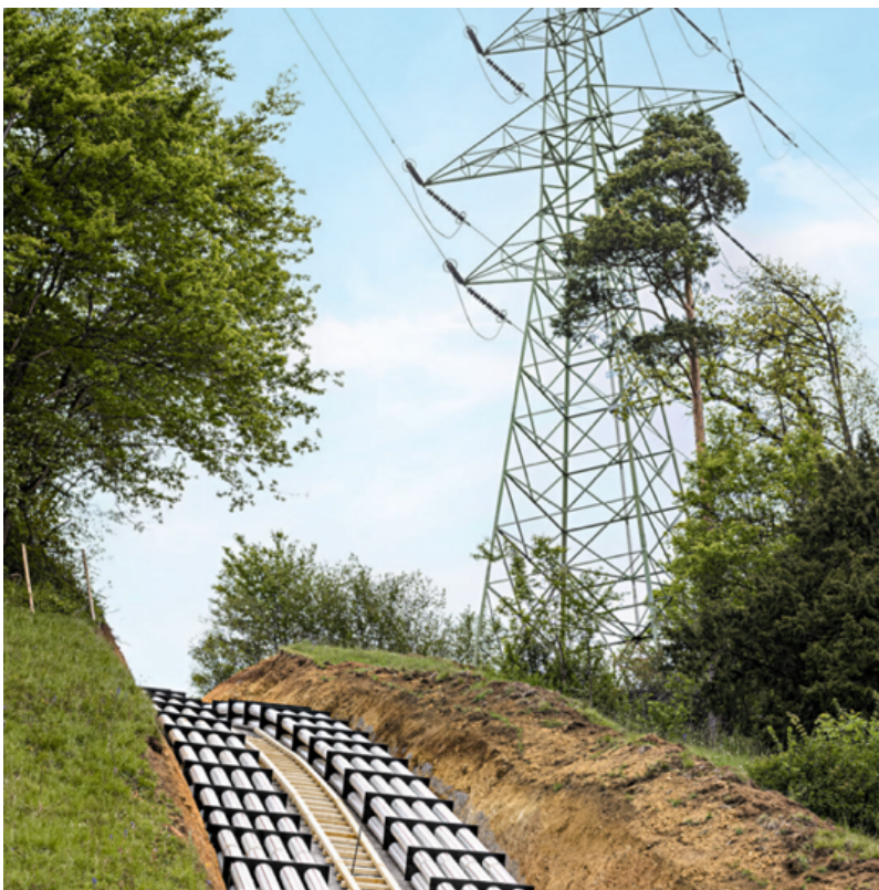
Swissgrid SA, Linee aeree e cavi interrati.
