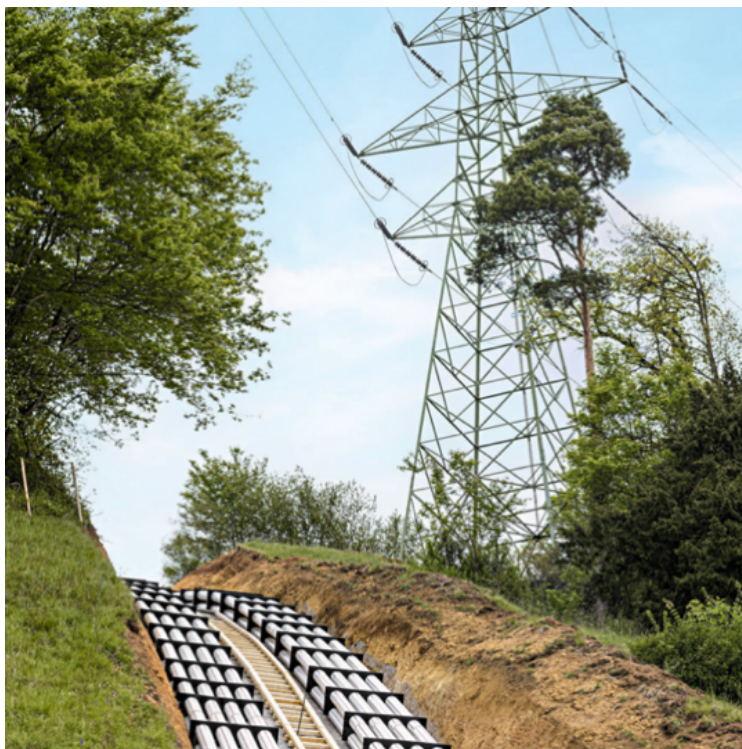
Swissgrid SA, Esempio di linee aeree e cavi interrati [6].
